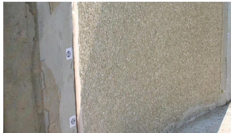
Brandschutztübbing mit PP-Fasern nach Brandversuch
